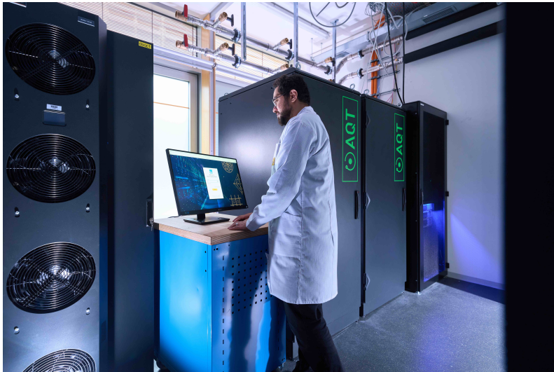
Abbildung 1: Arbeiten am neuen Ionenfallen-Quantencomputer: Hossam Ahmed, Ingenieur aus dem LRZ-Quantenteam, bereitet das AQT-System auf die Betriebsparameter im LRZ Quantum Integration Centre (QIC) vor. Bild: MQV — Jan Greune
